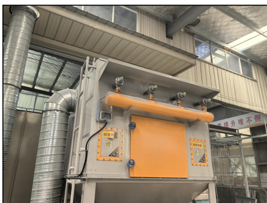
喷塑废气（布袋除尘器 TA005）
