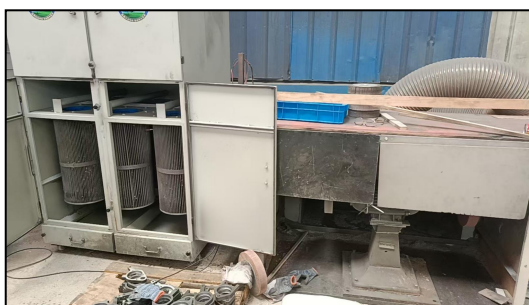
抛丸粉尘（砂轮机、滤筒除尘器 TA004）
