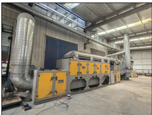
喷漆废气（废气治理措施 TA006）
