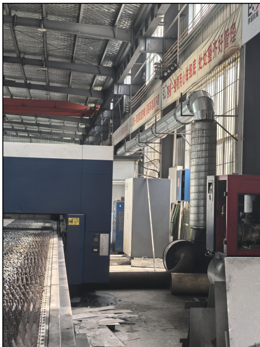
激光切割烟尘（管道连接）
