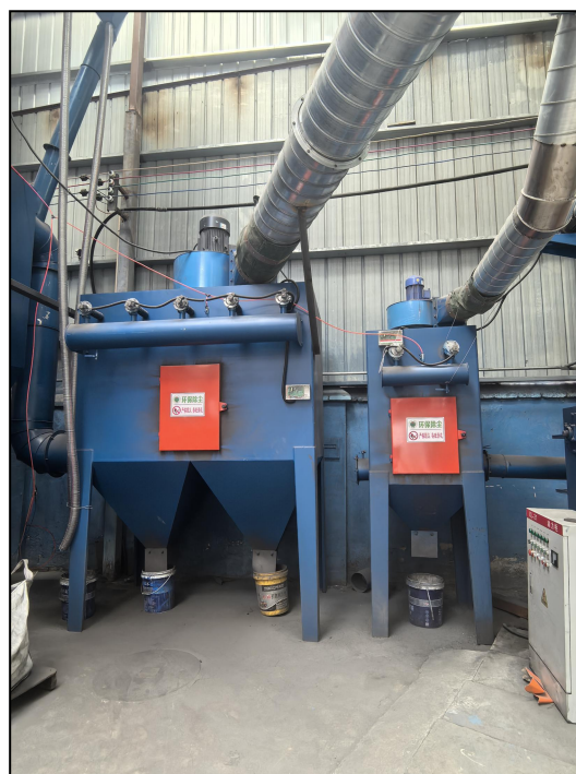
抛丸粉尘（滤筒除尘器，2 个 TA002、TA003）
