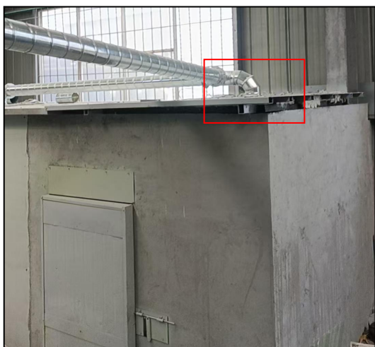
漆料仓库废气（管道收集）
