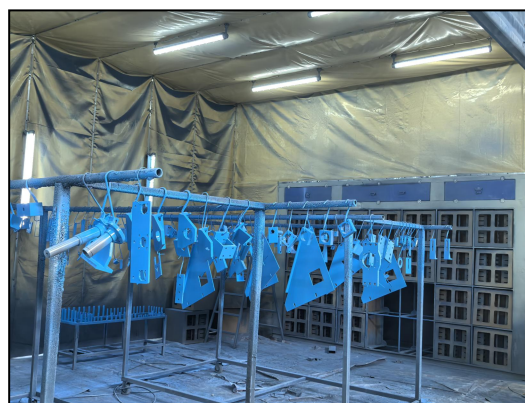
喷漆废气（喷漆房）
