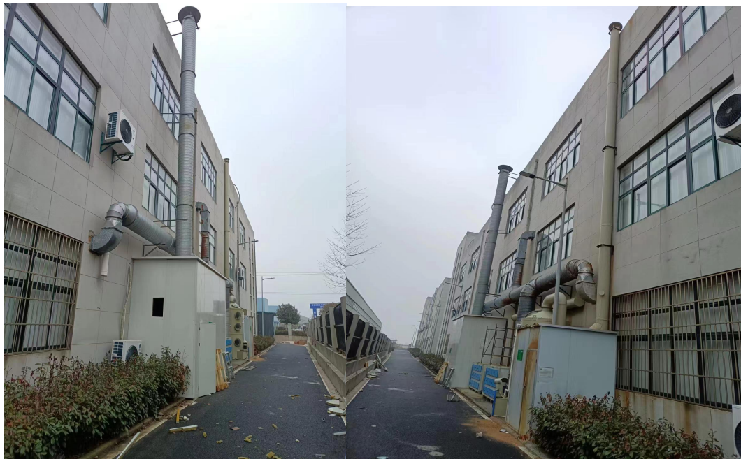
DA001 排气筒及二级活性炭装置
