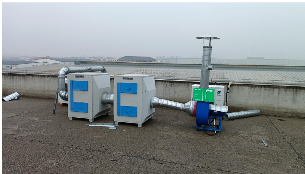
DA003 排气筒及二级活性炭装置
